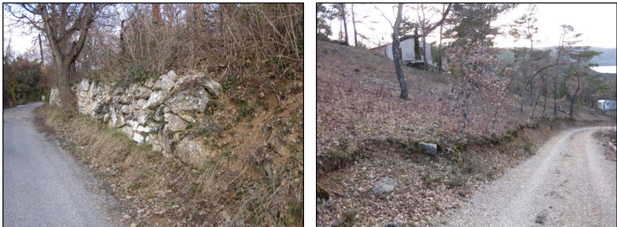
Figure 33 : Mur bombé et arbres tordus dans le secteur du Chemin de la Tuilière [Source : IMS RN ]
