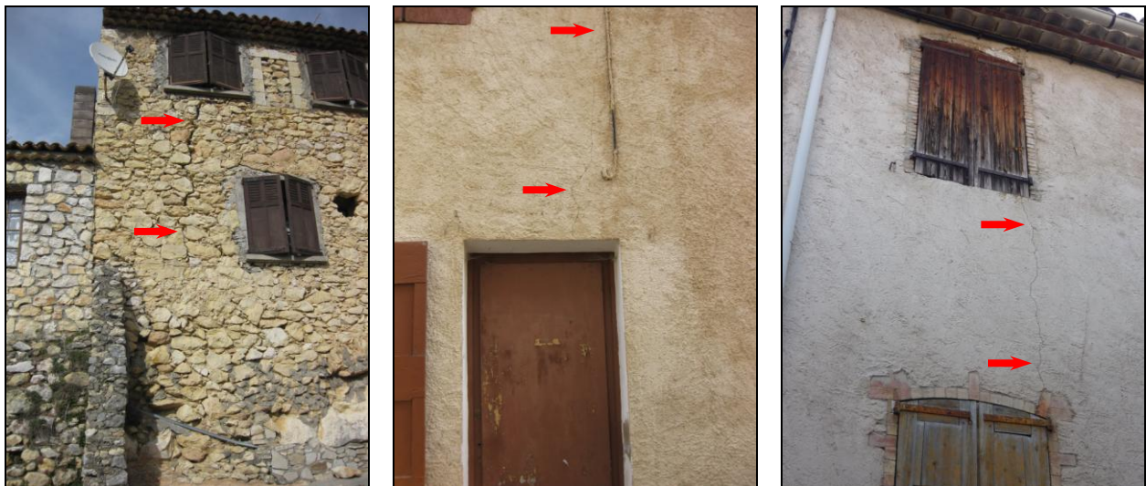
Figure 35 : Fissures sur des maisons, secteur de la rue Sainte-Anne [Source : IMS RN ]
