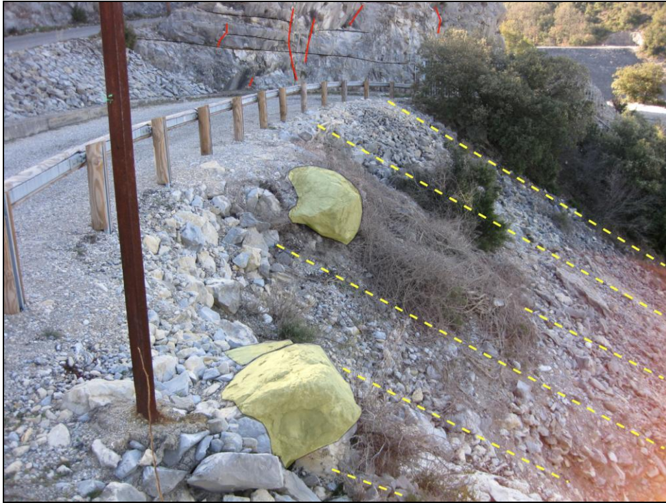
Figure 21 : Tablier d'éboulis en bordure de la RD 315, au niveau du barrage (Site STEV01) [Source : IMS RN ]
