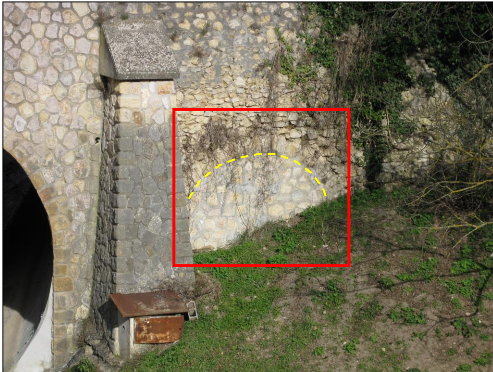
Figure 49 : Torrent d'Albosc, passage sous la RD 82 (détail d'une arche, désormais murée, de l'ancien pont) [Source : IMS RN ]
