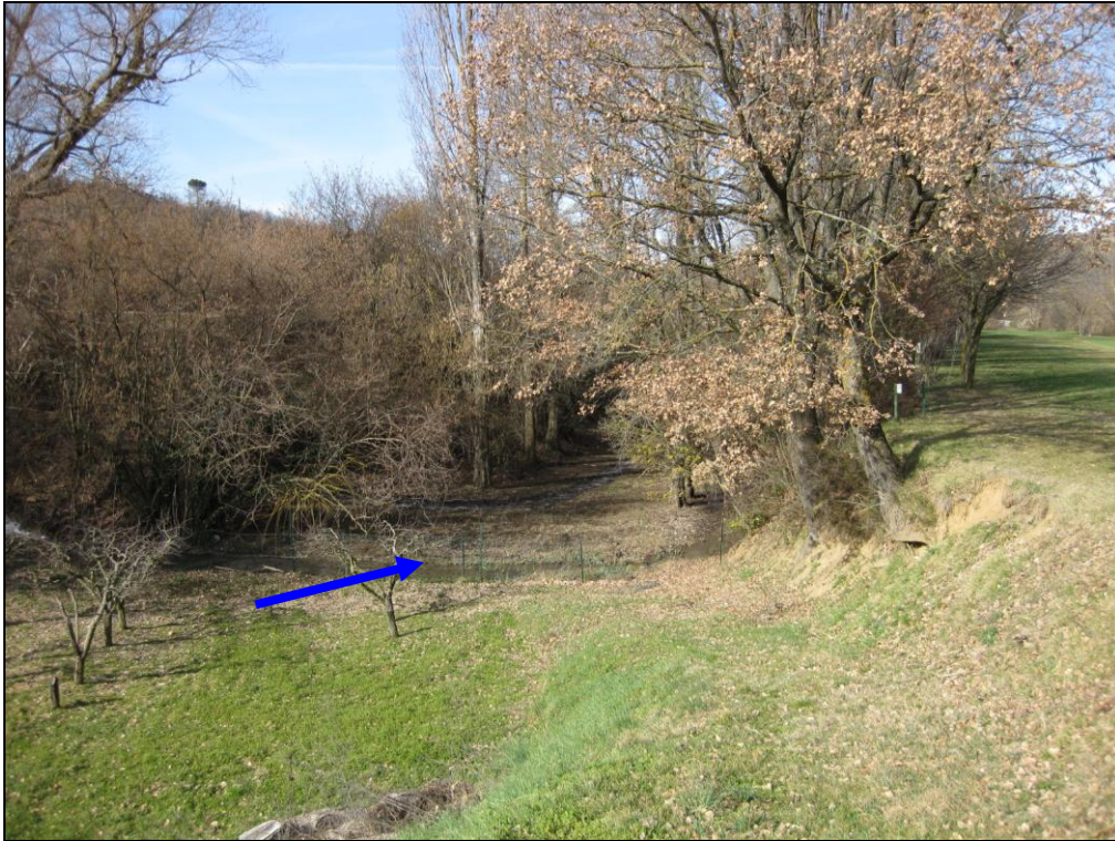
Figure 44 : Torrent d'Albosc, au niveau de Grand Pré [Source : IMS RN ]
